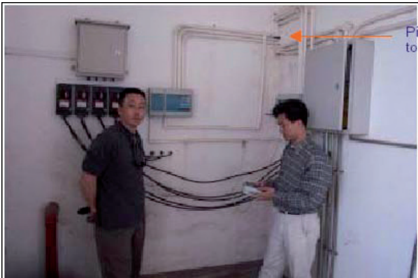
图 2 - 将VESDA安装在控制室里
