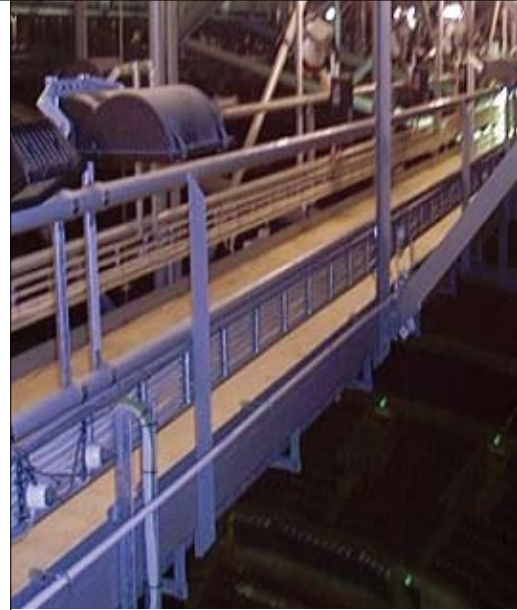
VESDA探测器被安装在距地面12米高的人行步道的入口处，便于接近，维护和测试工作都非常方便。
