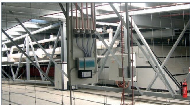
图4 - 屋顶空间内的探测器和管道
