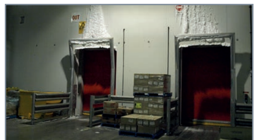
图1 - 冷冻间入口处的结冰
