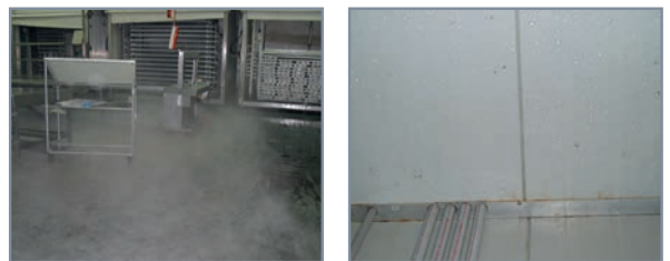
图1 - VESDA管道安装在天花板瓷砖有大量冷凝水的加工厂中
