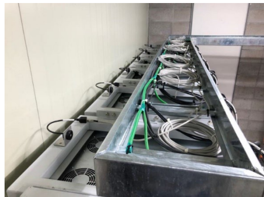
图 12：安装在电池架顶部的监测传感器
