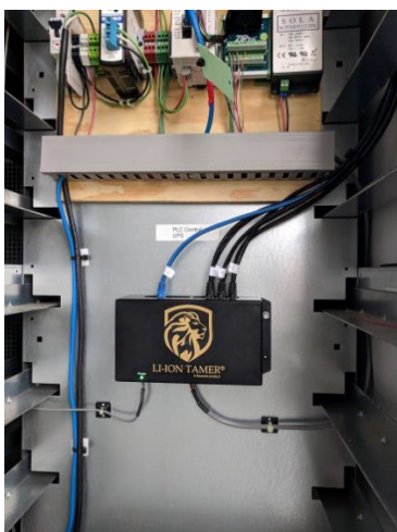
图 4：控制器连接到系统控制室
