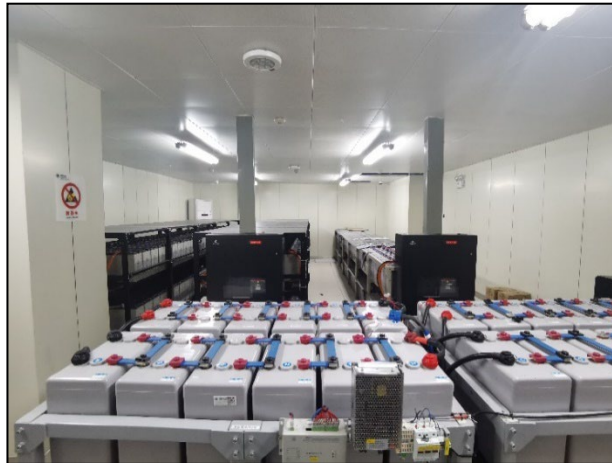
图1：电池室（赤峰电站）
