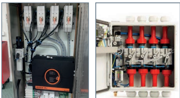
Figure 3 : Système de décolmatage automatisé
