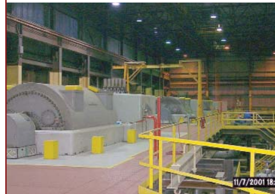
Generatoren der Stufe 2 mit VESDA Ansaugrohrleitungen im überwachten Bereich und einem Detektor, der zu Wartungszwecken leicht zugänglich in einer Steuerwarte installiert ist.
