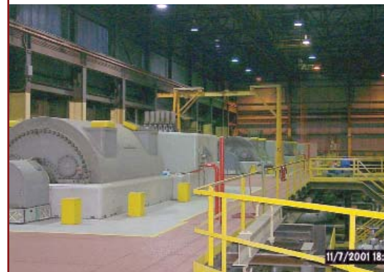
Generadores de nivel 2 con tuberías de muestreo VESDA en un área protegida, y unidad de detección montada en una sala de control para facilitar el acceso y el mantenimiento.
