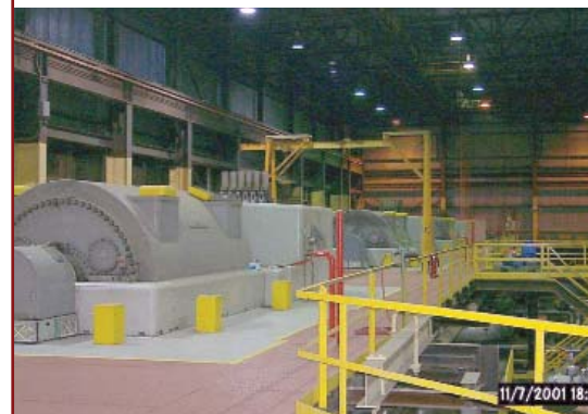
Geradores de nível 2 com tubagem de recolha de amostras VESDA numa área protegida, e unidade de detecção montada num compartimento de controlo para fácil acesso e manutenção.
