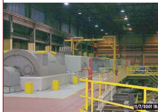
Area dei generatori di livello 2 protetta con le tubazioni di campionamento VESDA e con l'unità di rilevazione montata in una sala di controllo per una facile manutenzione.
