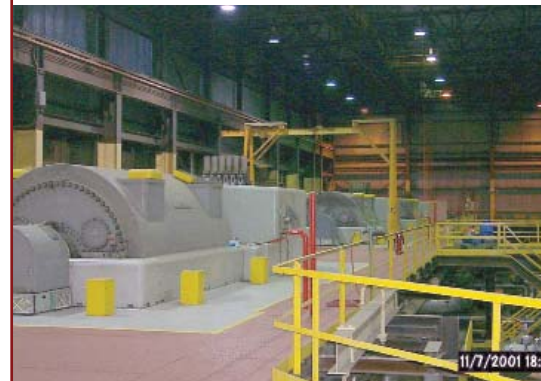
Генераторы 2 уровня с пробоотборным воздухопроводом VESDA в защищенной области и детекторным модулем, расположенным в аппаратной комнате для удобства доступа и техобслуживания.
