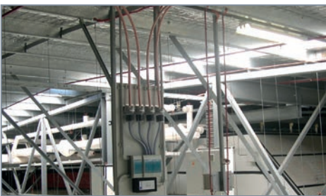
Figura 4 - Detector y tubos en el espacio del techo
