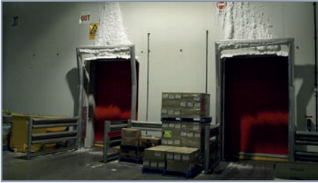
Figura 1 - Escarcha en el ingreso a la habitación fría
