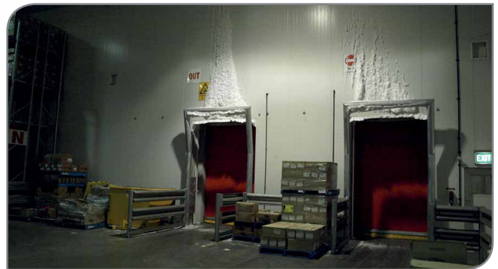
Figura 1 - Escarcha en el ingreso a la habitación fría
