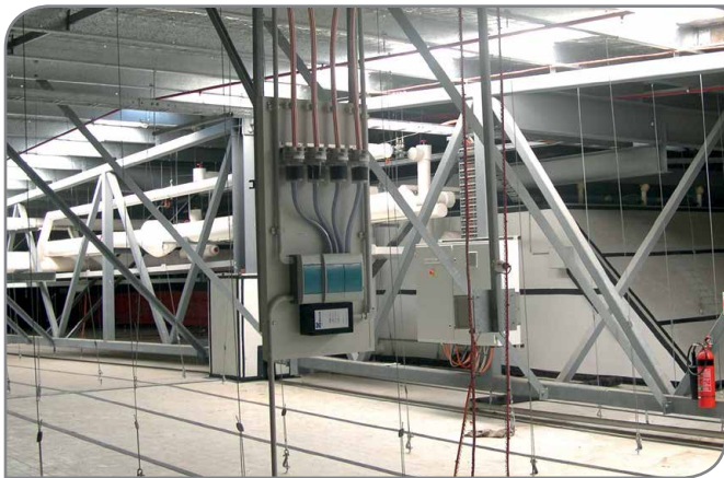
Figura 4 - Detector y tubos en el espacio del techo
