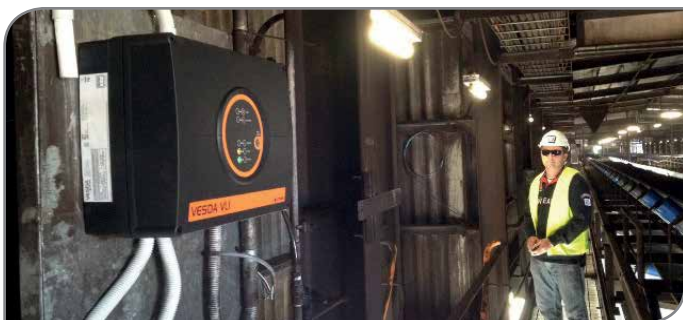
Figura 1 - VESDA VLI en un túnel con transportadora
