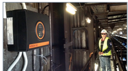
Figura 1 - VESDA VLI en un túnel con transportadora
