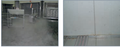
Figura 1 - Condensación en los azulejos del techo en donde está ubicado el tubo VESDA en un complejo de procesamiento
