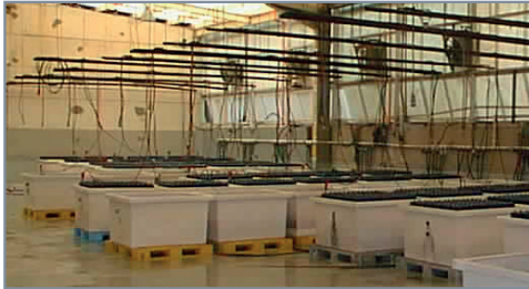
Figura 2 - Sala de carga / llenado de baterías
