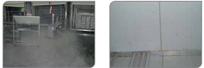
Figura 1 - Condensación en los azulejos del techo en donde está ubicado el tubo VESDA en un complejo de procesamiento
