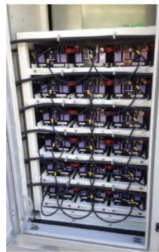
Lishen (équivalence : 3 blocs de batterie)
