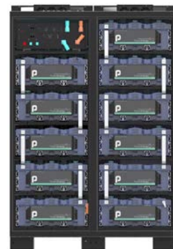
Powen: (équivalence : 2 blocs de batterie)
